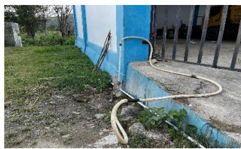
Gambar 4. Sumur Bor Pada UPTD TPA Kawatuna
